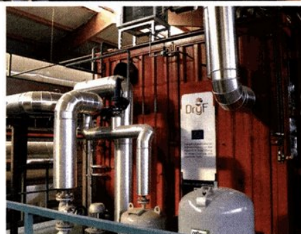
Erste industrielle Hochtemperatur-Wärmepumpe bei der Wienerberger Österreich GmbH am Standort Uttendorf im Demobetrieb.
